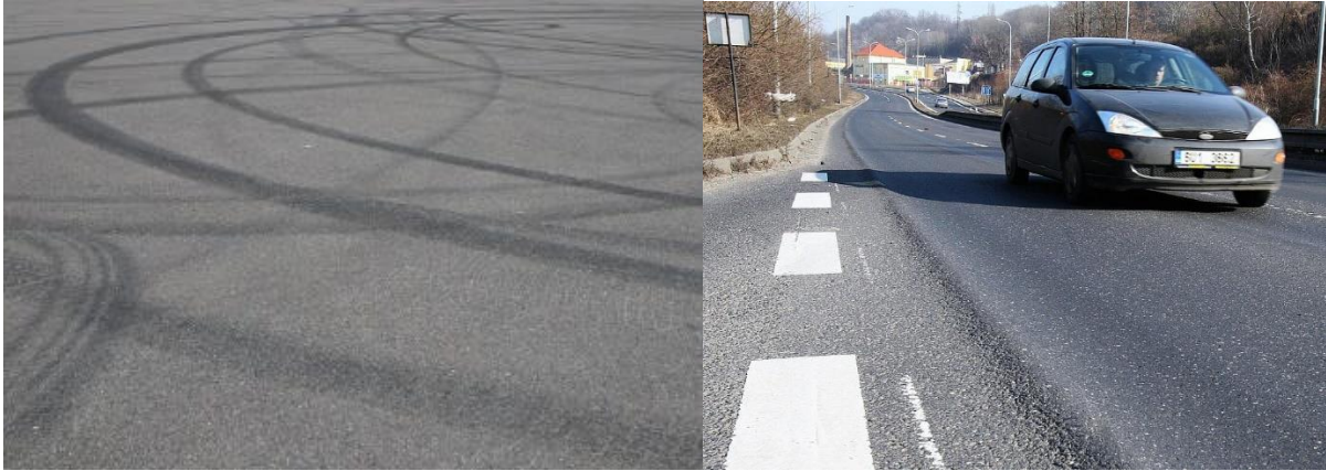
Şekil 2.6. Tekerlek izi(oluklanma) örneği
