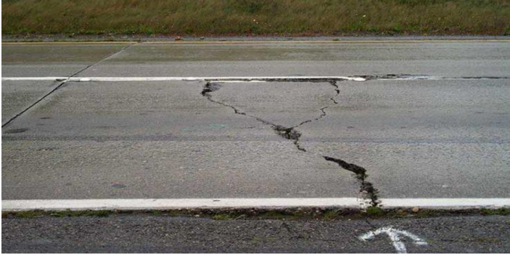
Şekil 2.8. Yansıma çatlağı örneği
