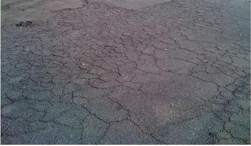
Şekil 2.7. Timsah sırtı çatlağı örneği
