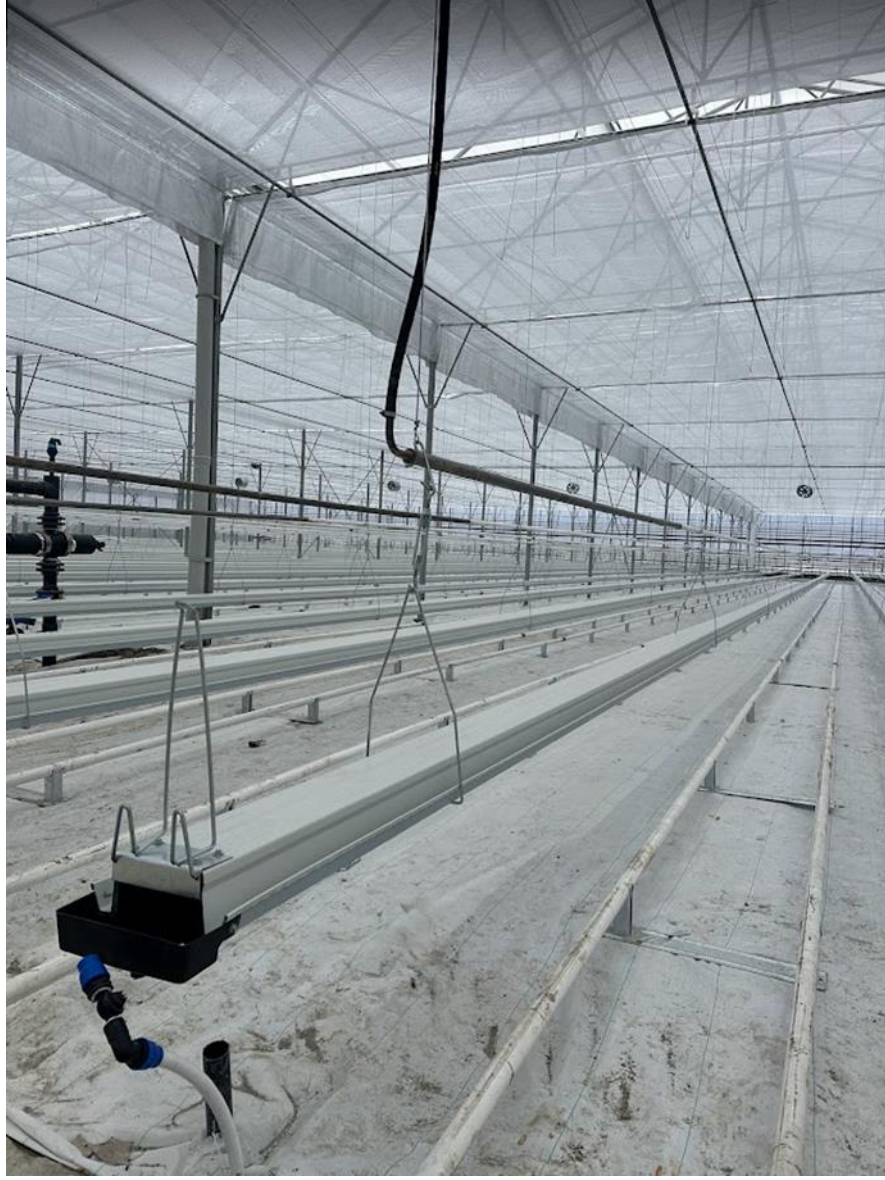
Şekil 39. Seranın Gutter sehpaları
