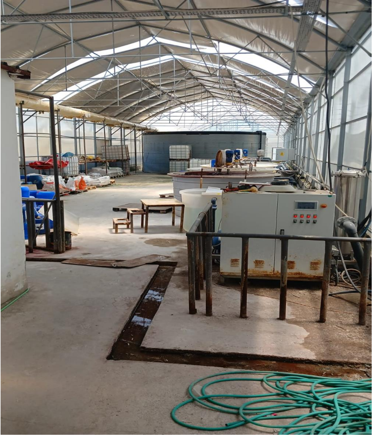
Şekil 43. Yozgat İli Sorgun İlçesi sera su ve gübreleme tankları
