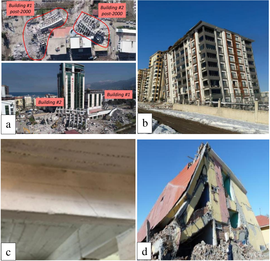
Şekil 1. 2. a) Burulma Düzensizliği Nedeniyle Çöken İki Bina (Vuran ve diğ., 2025), b) Burulma Sebepi Ağır Hasar Alan Bina (Akbaş ve diğ., 2023), c) Betonarme Kiriş Elemanda Burulma Çatlakları (Canpolat ve diğ., 2023), d) Burulma Etkisi İle Yıkılan Okul Binası (Doğan ve diğ., 2013)
